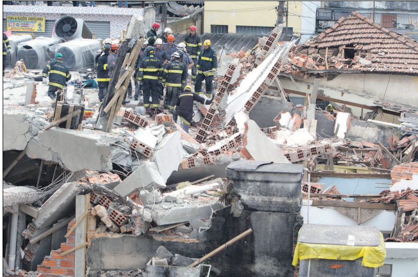
Bombeiros procuram vítimas na obra que desabou em São Mateus, na zona leste: prédio não possuía alvará da Prefeitura e tinha sido embargado.
